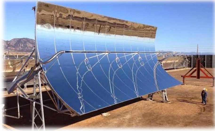
الشكل 2.1. يوضح احواض توليد الطاقة الشمسية
