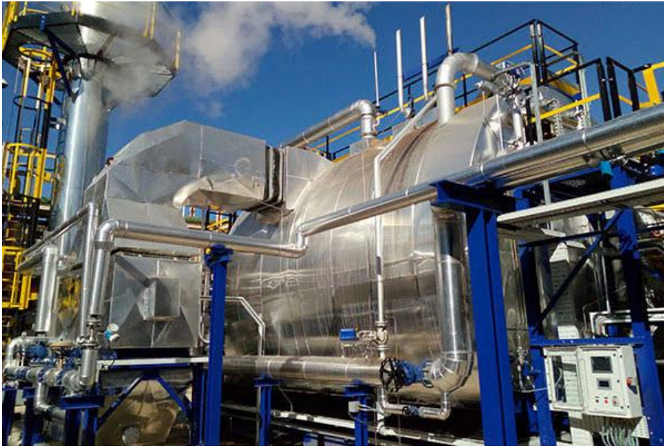
الشكل 5.2. يوضح غلاية مواسير المياه
