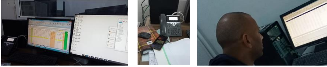
الشكل 23 . غرفة التحكم
