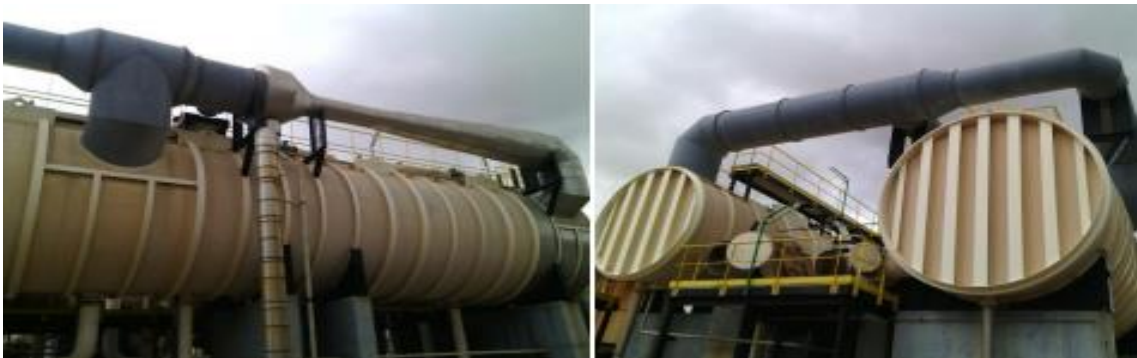
Figure III.5: Thermo-compresseur prise de la station de dessalement TCD 6-8000. [78]
