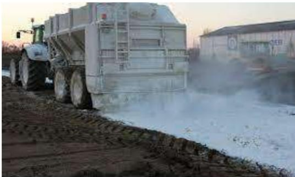
Figure.II.18. Chantier de traitement du sol a la chaux. [Ben younes.F et al.2021]
