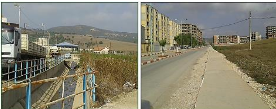
Figure 4.13. La réalisation de l'aménagement de m'embouchure de l'oued Zerga et l'aménagement du canal qui longe la RN 03 à Ramadan Djamal.
