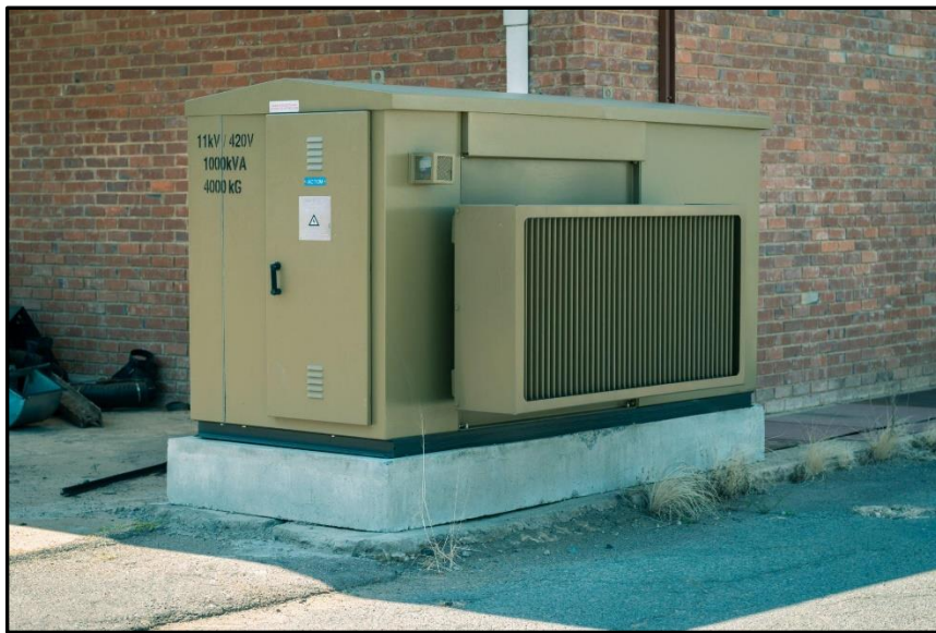
الشكل 14.1: مَحَوِّل خافض للجهد. (Pad mount transformer)
