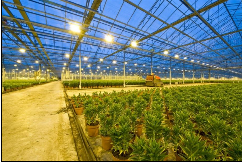
الشكل 4.1: إنارة كهربائية داخل بيت بلاستيكي.
