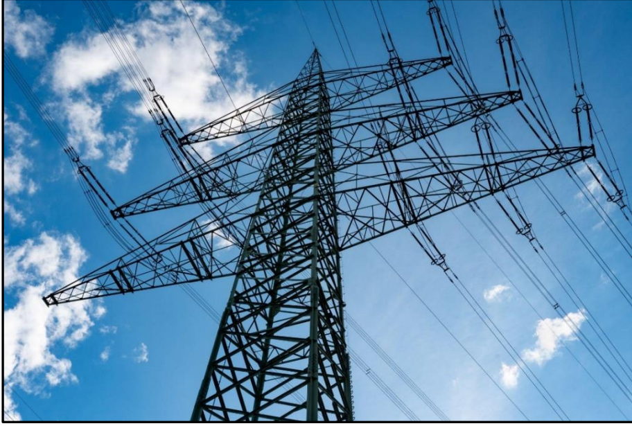
الشكل 12.1: خطوط نقل الكهرباء مثبتة على أبراج فولاذية.
